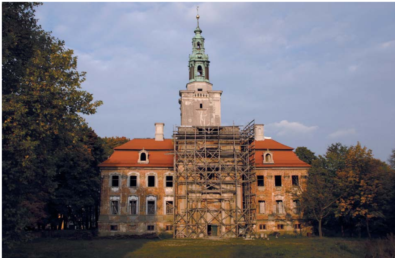
Ryc. 80. Chocianów. Pałac wzniesiony w miejscu średniowiecznego zamku, widok od południowego zachodu (fot. A. Boguszewicz).
